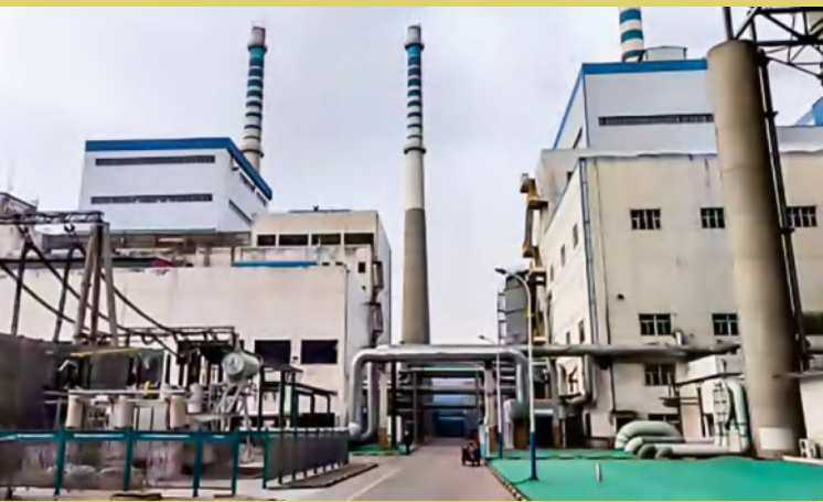
电厂乏汽余热回收利用项目：神木乏汽余热回收利用项目
