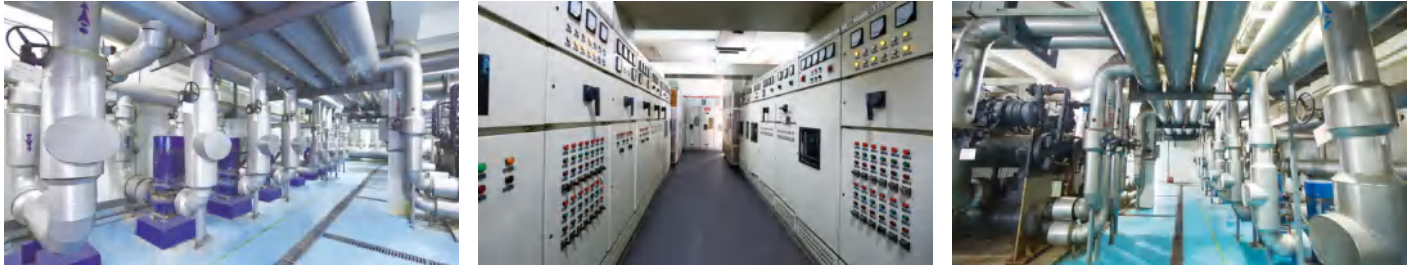
浅层地下水源热泵机房
